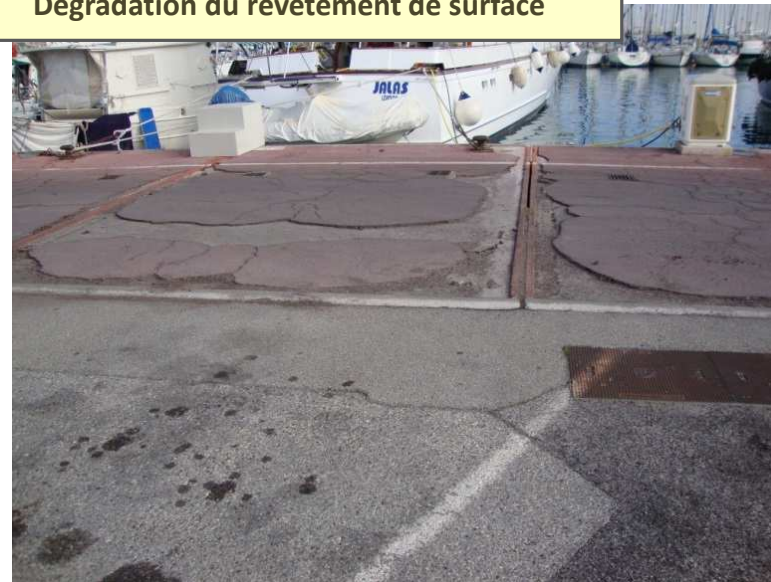
Dégradation du revêtement de surface
