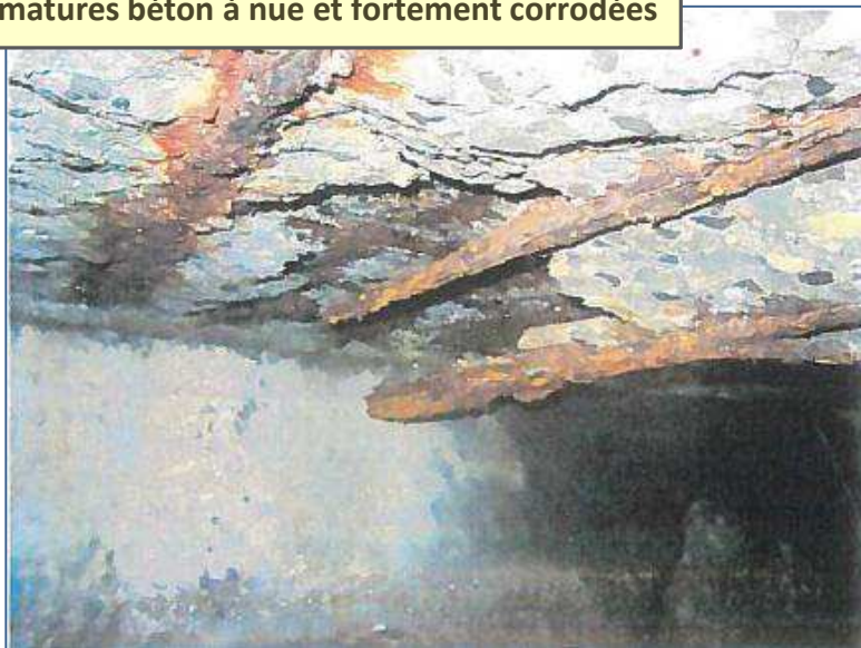
Armatures béton à nue et fortement corrodées
